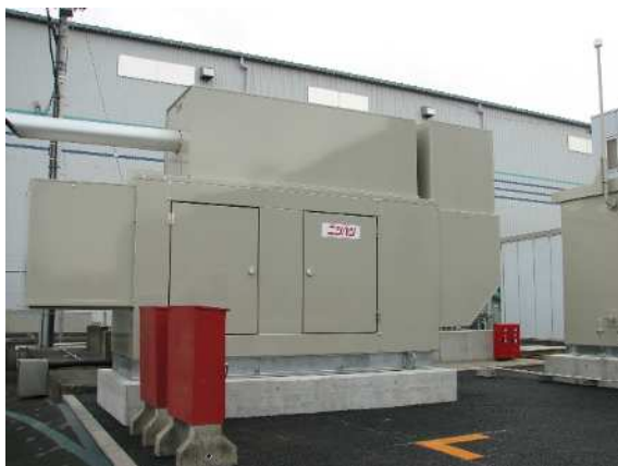
自家発電装置
