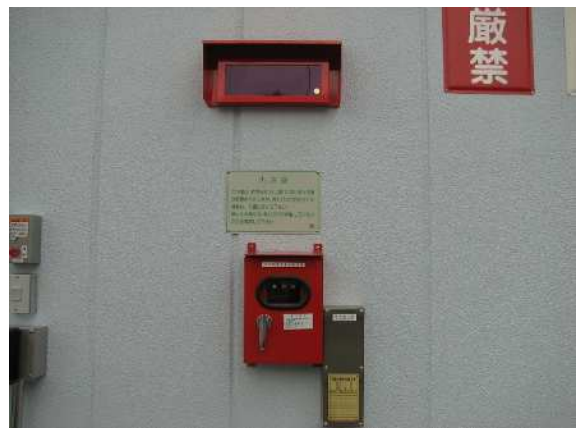
二酸化炭素消火設備
